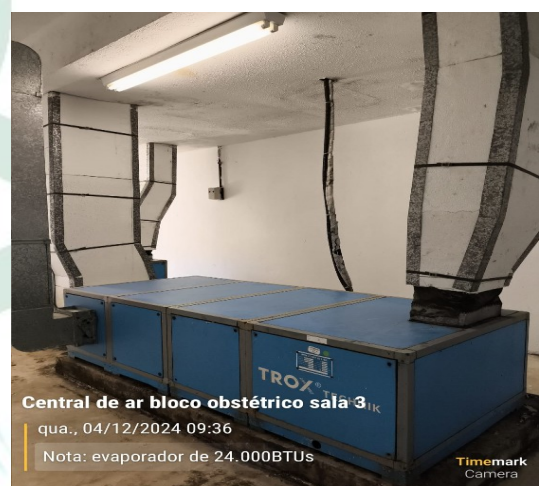
Evaporadora sala 3 bloco OBS
