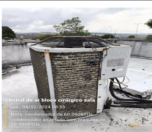
Condensadora 60.000 BTUs sala 3 cirúrgico
