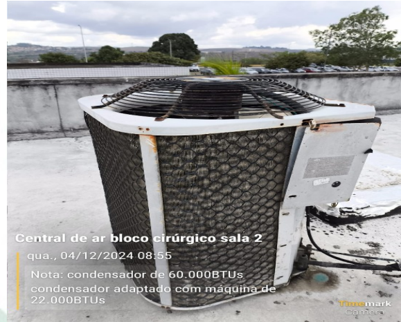
Condensadora 60.000 BTUs sala 2 cirúrgico
