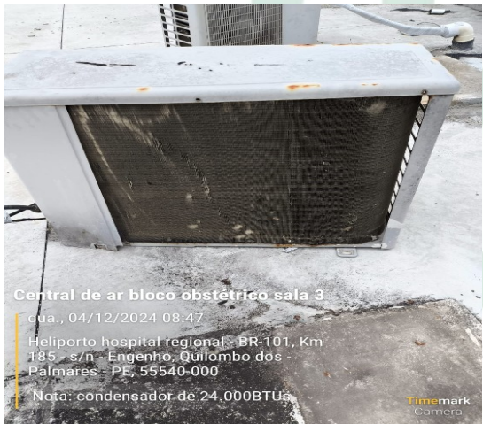
Condensadora 24.000 BTUs sala 3 OBS
