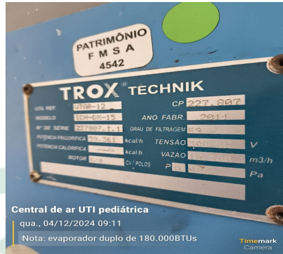
Evaporadora UTI PED
