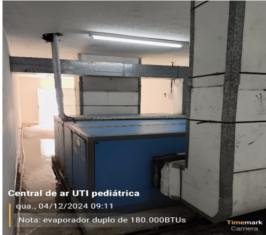
Evaporadora UTI PED
