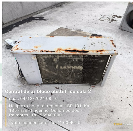
Condensadora 24.000 BTUs sala 2 OBS
