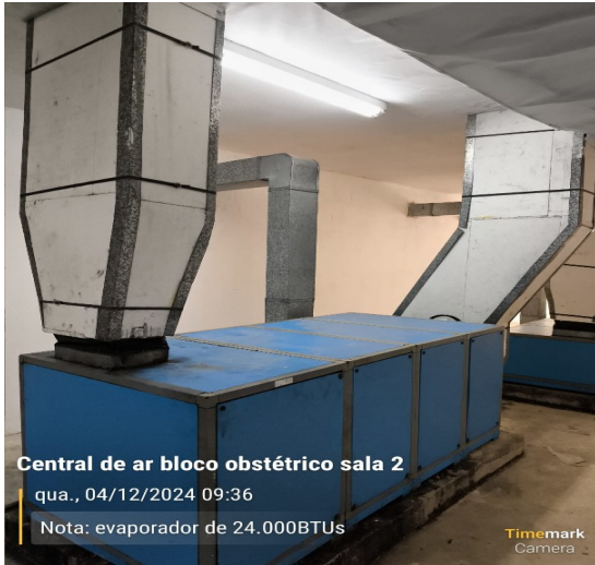
Evaporadora sala 2 bloco OBS
