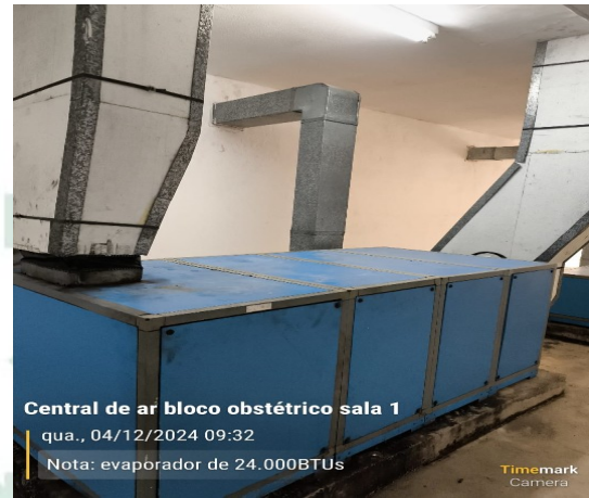
Evaporadora sala 1 bloco OBS
