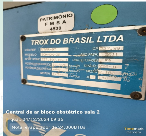
Evaporadora sala 2 bloco OBS
