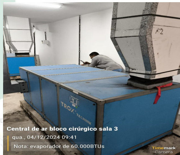
Evaporadora sala 3 bloco Cirúrgico
