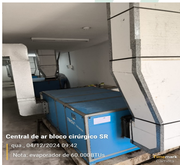
Evaporadora sala SR bloco Cirúrgico
